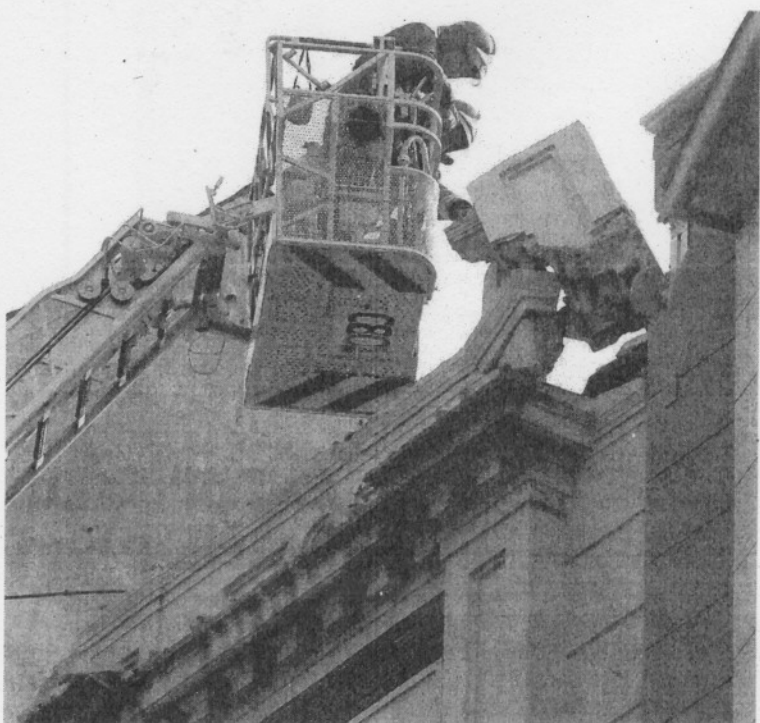
▲ Los bomberos. Con una grúa comprobaron el estado del interior del edificio y eliminaron varias piezas rotas de la fachada que corrían peligro de caer a la calle.
